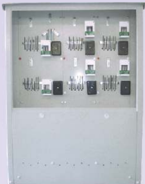
Elektroměrový rozvaděč v pilíři
